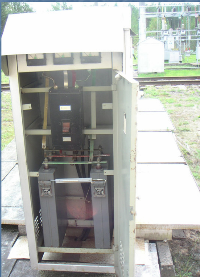
Kondensatoru baterija ekspluatācijā
